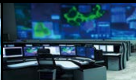
コントロールルーム
