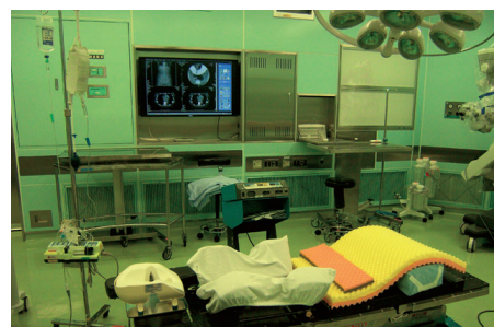
手術室内壁面に設置されたFWD-S47H1。
