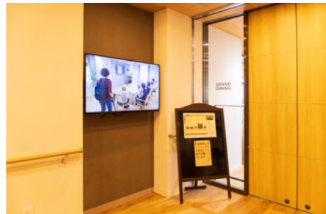
ダイニングのエントランスにサイネージ用ブラビア（43V型）を設置
