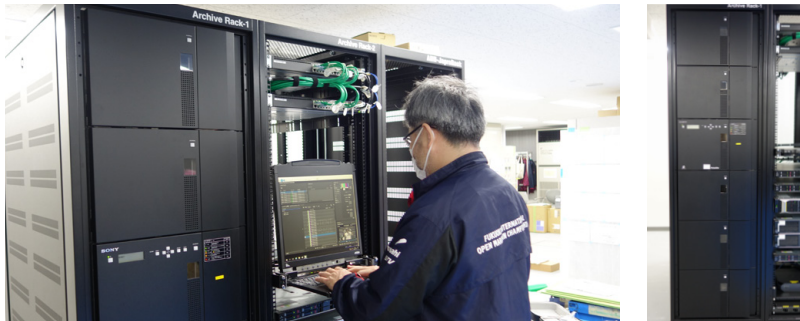
サーバー室に設置されたPetaSite 拡張型ライブラリーシステムと Media backbone Ensemble
