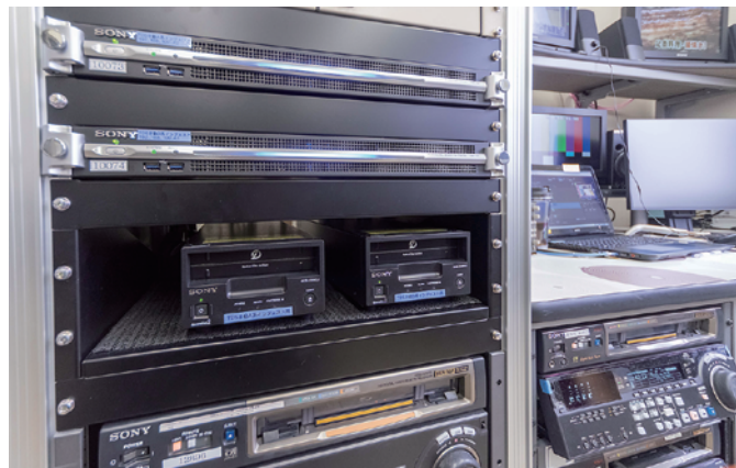
PWS-100TD1にはODS-D280Uが1台ずつ接続され、ODAカートリッジへの書き込みを行っている
