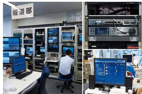
回線収録ブース。インジェスト端末4 系統を装備し、浜松支局や下田支局、各駐在地、各地の情報カメラ、そして系列局からの素材収録を行っています。写真・右上が収録用XDCAM Station XDS-PD 1000、写真・右下は収録素材の確認用端末。
