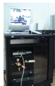
東京本社のビデオ会議は、持ち運びを考慮してキャビネットに収容されている。
