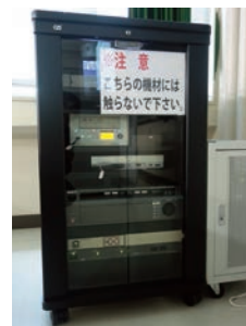
必要な機材をラックにまとめメンテナンス性を向上
