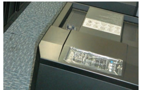
サーバールームに設置されたESSP-2000L。
