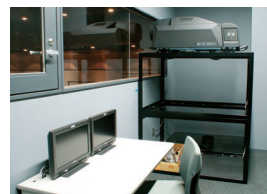
映写室に設置されたSRX-R105。
