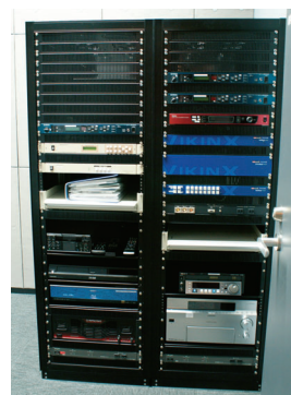
各種レコーダーを収容した映写室のデッキラック。
