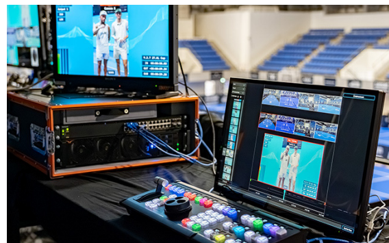
現場に仮設されたリプレイ環境 奥の可搬型ラック 下半分（2U）に 『HawkREPLAY』本体が搭載されている
