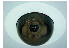
手術室の天井に設置したネットワークカメラSNC-RZ30N。ドームハウジングに収容し、圧迫感を軽減している。
