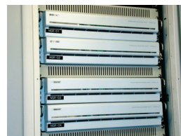
ネットワークカメラ専用レコーダー NSR-100は、警備本部モニター室内のサーバラックに収容されている。
