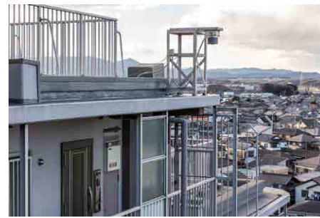
最上階の高さに設置された4Kカメラ
