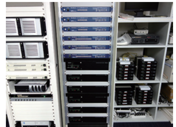
館内と外周部のセキュリティシステムを総合的に運用管理する防災センター
