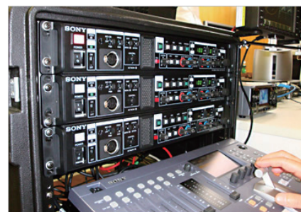
小型ラックに組み込まれた HXCU-D70、MCS-8M
