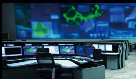
コントロールルーム
